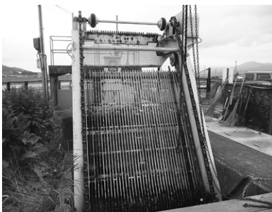
老朽化が著しい白山堂除塵機 (河北町西里地内)
