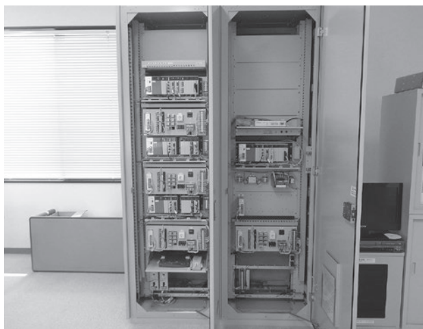
通信回線制御装置の更新
