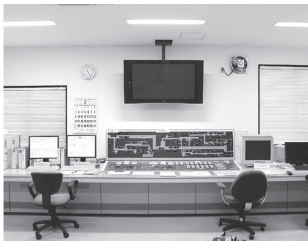
中央管理棟の操作盤
