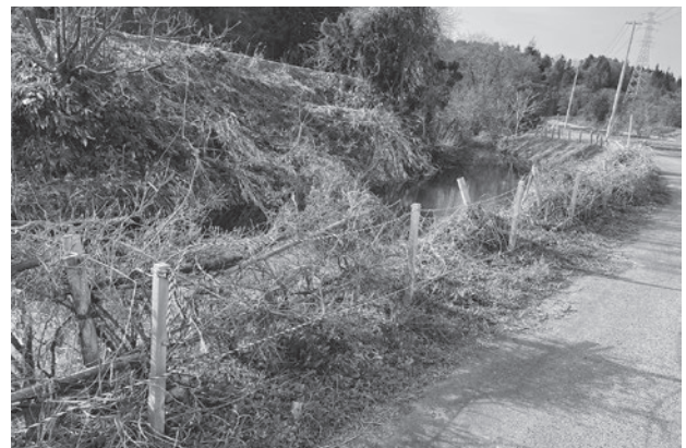
一ノ堰用水路安全柵
