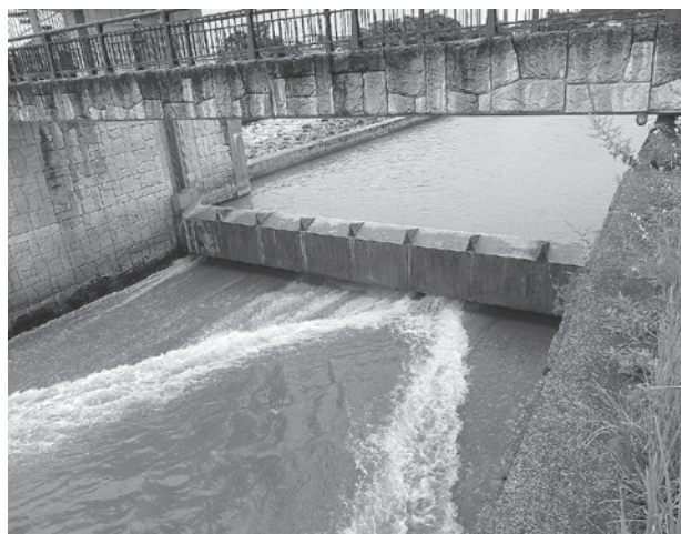
土砂吐ゲート全閉不能状況
